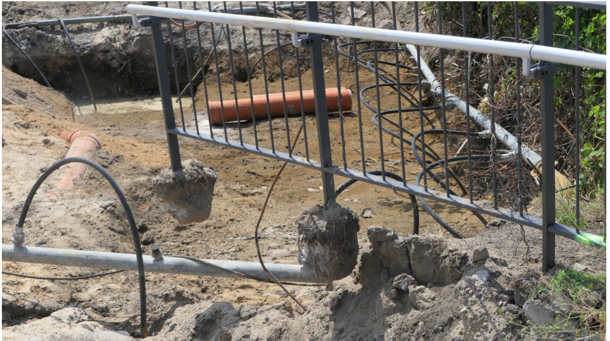
Aufnahme Julil 2019: Auch ein Teil des Geländers des EU-geförderten Weges ist abgerissen.
