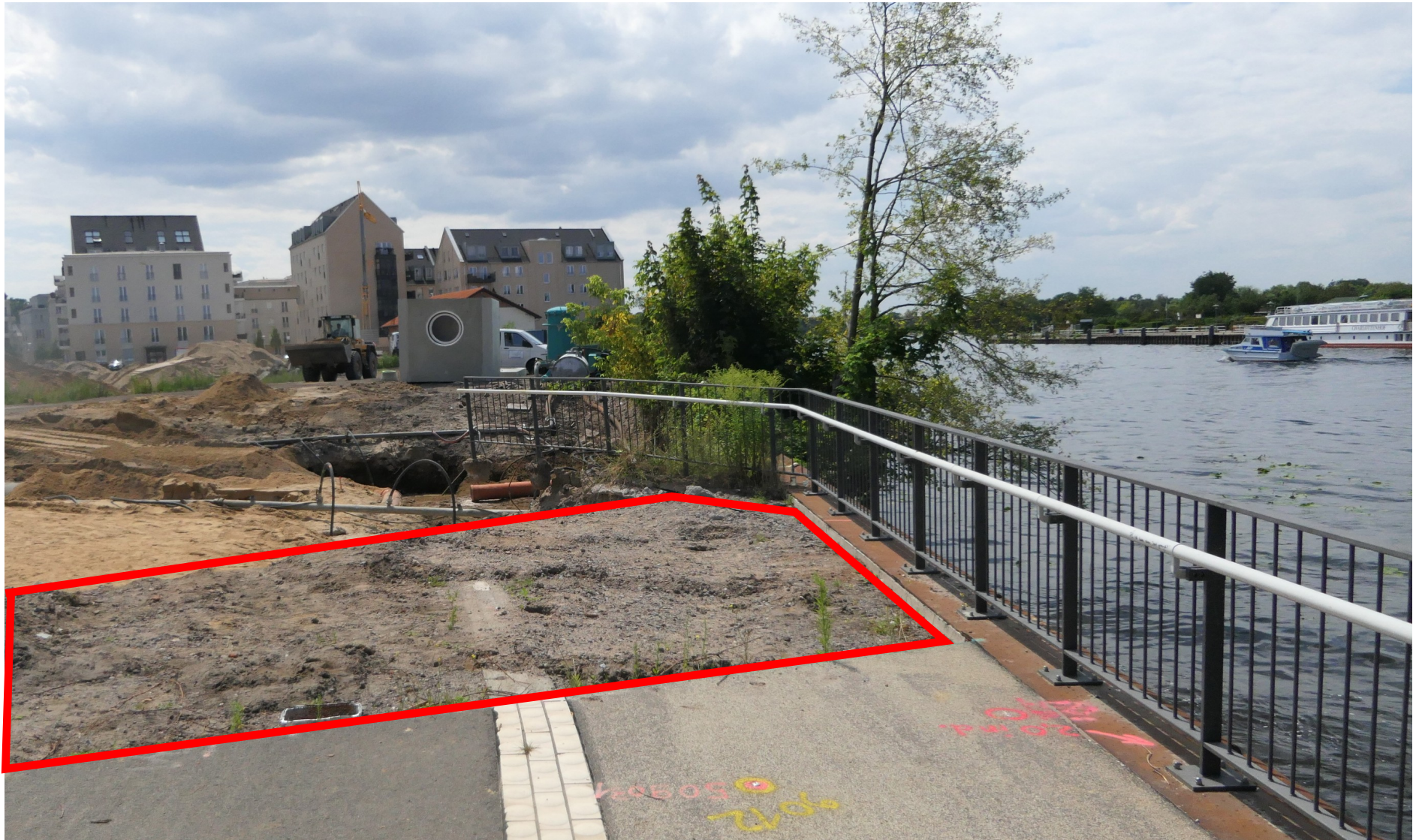
Aufnahme Juli 2019: Ein weiter Teil des EU-geförderten Weges ist abgerissen.
